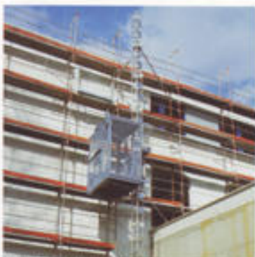
Personen- und Lastenaufzüge
